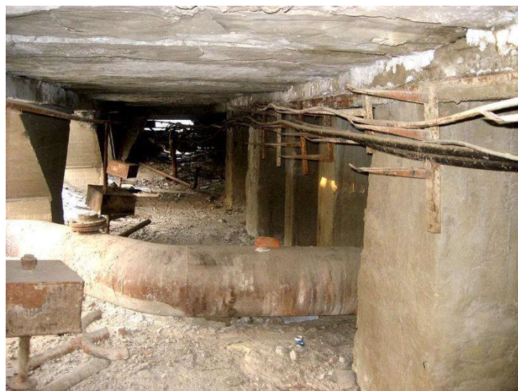
Рис. 1. Проветриваемое подполье под главным корпусом Якутской ТЭЦ (фото С. И. Заболотника, 5 ноября 2009 г.) / Fig. 1. Ventilated underground under the main building of the Yakutsk TPP (photo by S. I. Zabolotnik, November 5, 2009)
